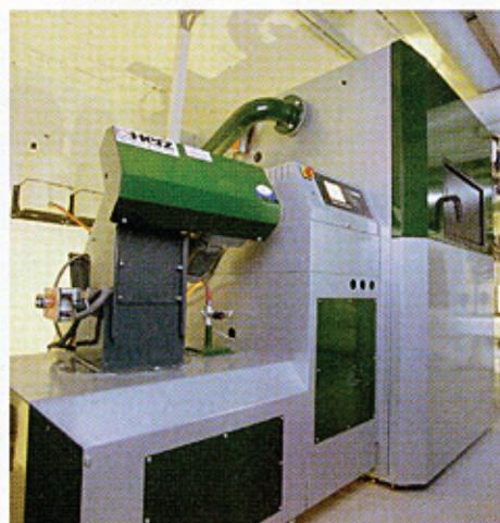
High-Tech mit Holz: Moderner Pellet-Kessel.
