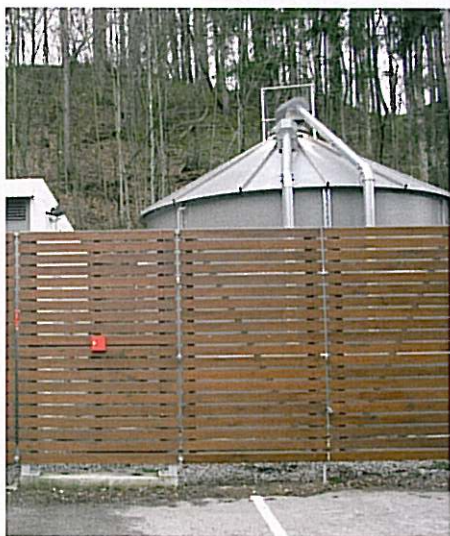
Realisiert wurde die Anlage von Proenergy
