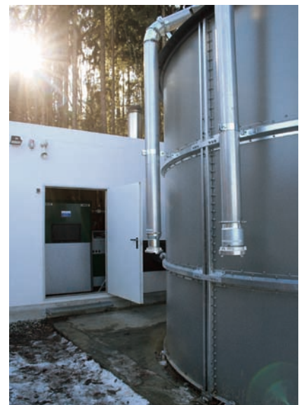
Am Hang oberhalb des Hotels befindet sich die Energiezentrale mit dem Container für die Heizkessel und dem Pellets-Silo.
