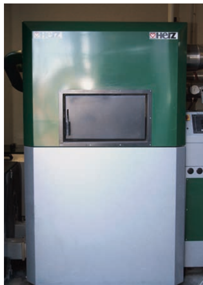
Das Herz der Wärmeversorgung im Hotel Schloss Fuschl: ein 500 kW Biomasseheizkessel des österreichischen Herstellers Herz.
